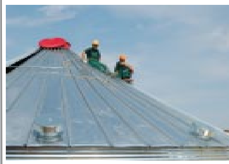
Не новый цирк, а мини-элеватор, чтобы сушили без потерь зерно. Строительство мини-элеватора в ООО «Защитное», Курская область
